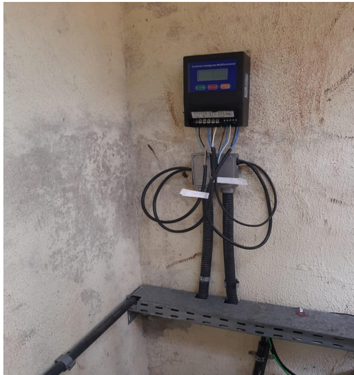
Foto 04 – Quadro de Comando Instalado
