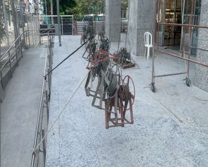
PISO EM GRANITO
