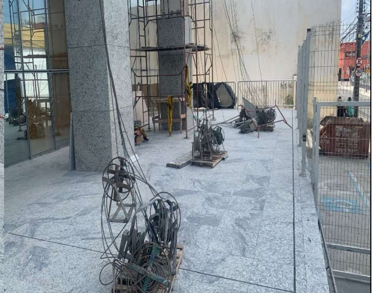
PISO EM GRANITO
