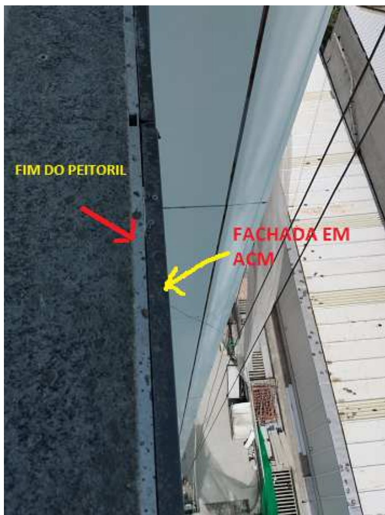
Foto 05 – Outra evidência de falha na ortogonalidade dos peitoris de granito com a fachada de painéis modulares de ACM.
