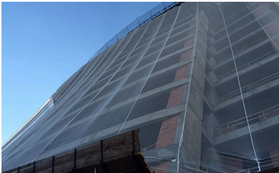
Foto 06 – Exemplo de estrutura metálica auxiliar assentada sobre a platibanda da Cobertura para fixação da tela de fachada.
