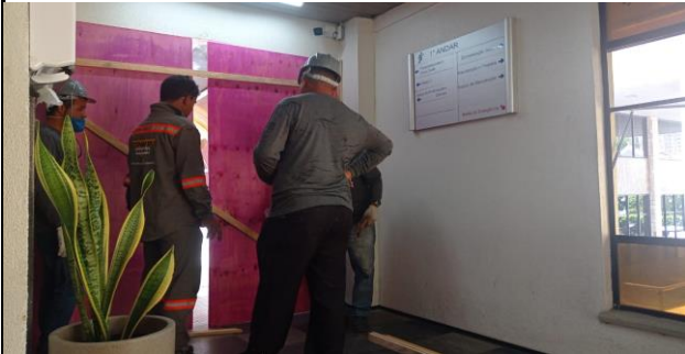
FOTO 07 - Interdição da Passarela Casa Sede / Anexo II.
