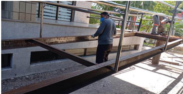
FOTO 07 - Desbastamento e lixamento dos perfis para remoção de toda ferrugem. Remoção dos perfis tipo "U" condenados.
