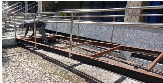
FOTO 08 - Desbastamento e lixamento dos perfis para remoção de toda ferrugem. Remoção dos perfis tipo "U" condenados.
