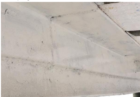
FOTO 11 - Pintura em epóxi da nova estrutura do segundo trecho da passarela que liga Anexo II / Casa Sede.
