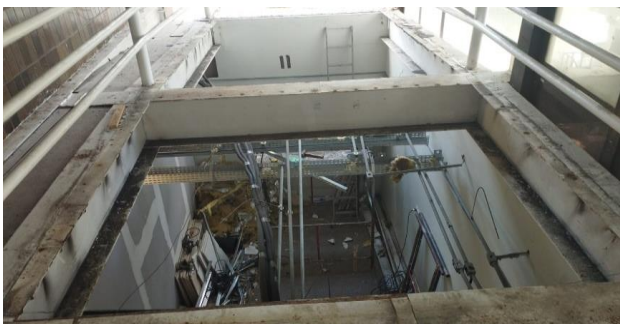
FOTO 03 - Remoção da estrutura metálica do segundo trecho da passarela que liga Anexo II / Casa Sede.
