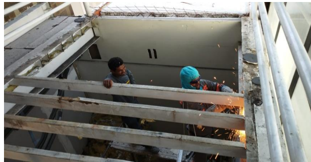
FOTO 02 - Remoção da estrutura metálica do segundo trecho da passarela que liga Anexo II / Casa Sede.
