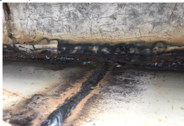
FOTO 06 - Soldagem da nova estrutura do segundo trecho da passarela que liga Anexo II / Casa Sede.
