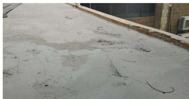
FOTO 12 - Concretagem do primeiro e do segundo trecho da passarela que liga Anexo II / Casa Sede.
