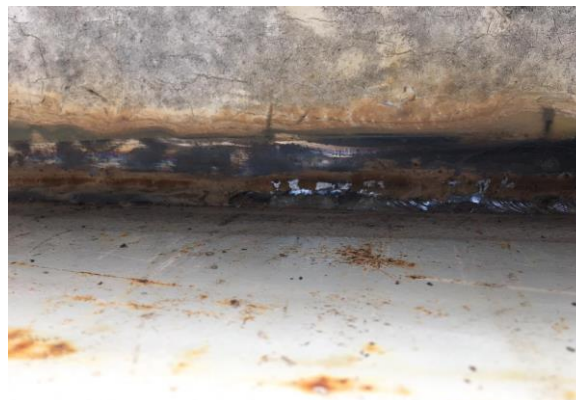
FOTO 04 - Soldagem da nova estrutura do segundo trecho da passarela que liga Anexo II / Casa Sede.
