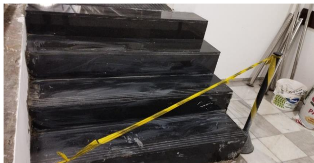
FOTO 16 - Assentamento das pedras de granito preto nos degraus da escada da anti sala.
