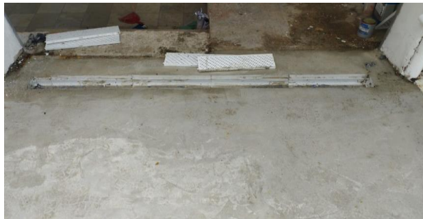
FOTO 08 - Execução de contra piso para preparo da laje para o piso de borracha e instalação de calha.
