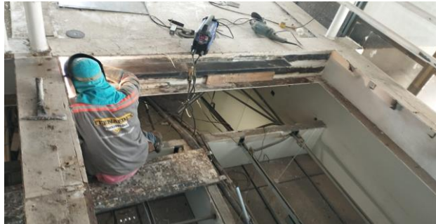
FOTO 02 - Soldagem da nova estrutura do terceiro trecho da passarela que liga Anexo I / Casa Sede.
