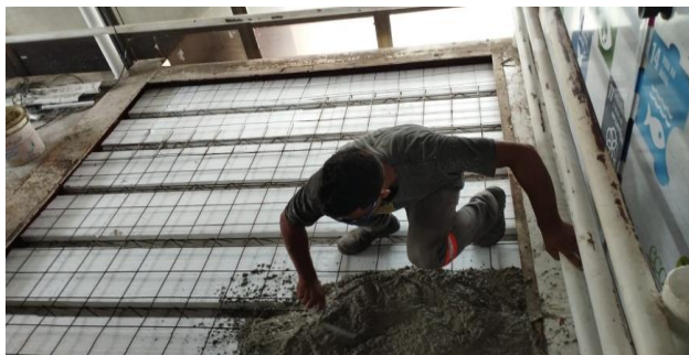
FOTO 03 - Concretagem do terceiro trecho da passarela que liga Anexo I / Casa Sede.
