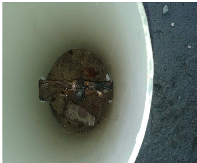
c) Caixa com haste de aterramento com solda exotermica
