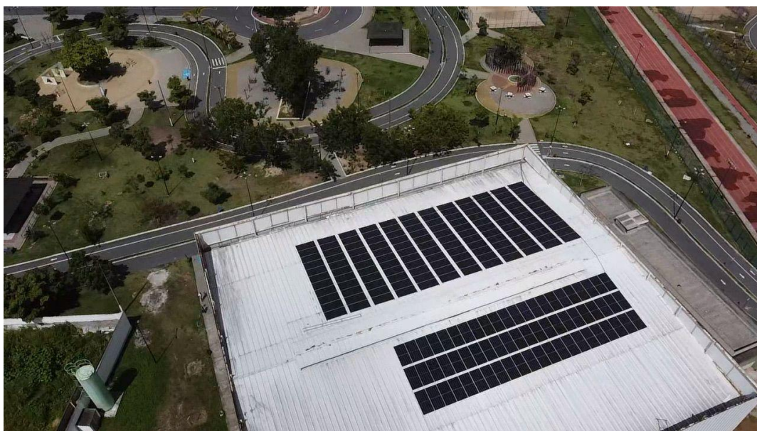
Figura 2 – Registro da instalação em telhado/coberta executada no PARQUE DA LIBERDADE – CAMPINA GRANDE - PB, utilizada como reforço visual da comprovação da capacidade técnica da SOLAR NOBRE COMÉRCIO E SERVIÇOS LTDA.
