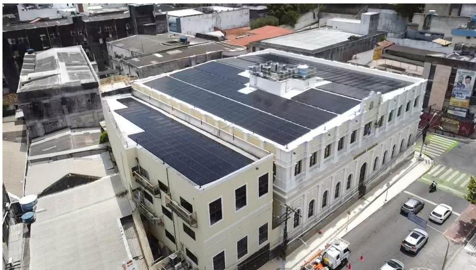
Figura 1 – Registro da instalação em telhado/coberta executada no âmbito do Contrato nº 20/2025/EQCON – MGI/AL, utilizada como reforço visual da comprovação da capacidade técnica da SOLAR NOBRE COMÉRCIO E SERVIÇOS LTDA.
