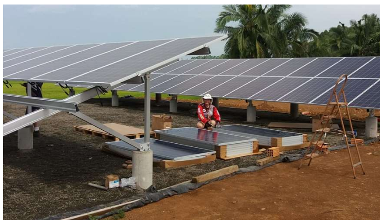
Figura -01 – Instalação ao Solo com detalhes da estrutura de fundação e estrutura metálica
