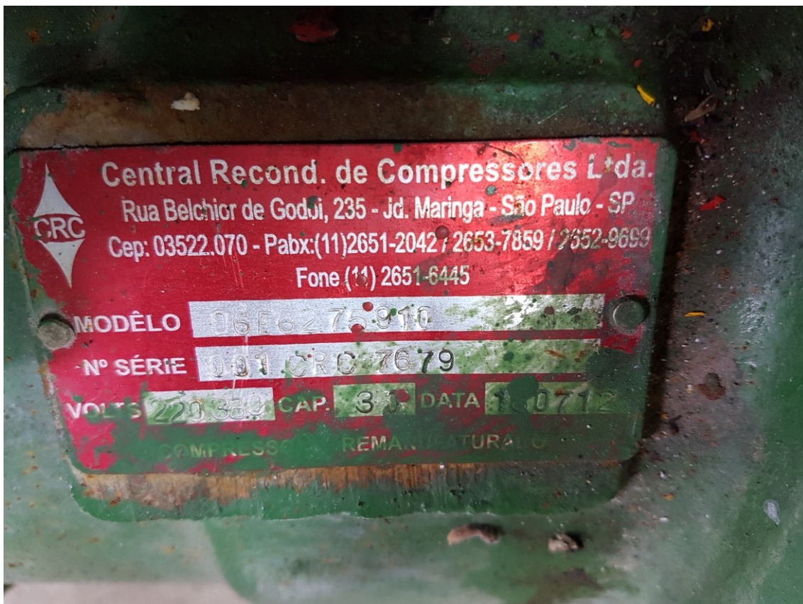
Figura 5 – Dados de Placa do compressor COMP6A3.
