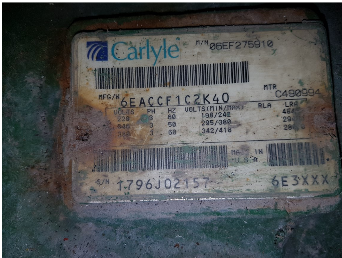
Figura 1 – Dados de placa compressor COMP5A2.
