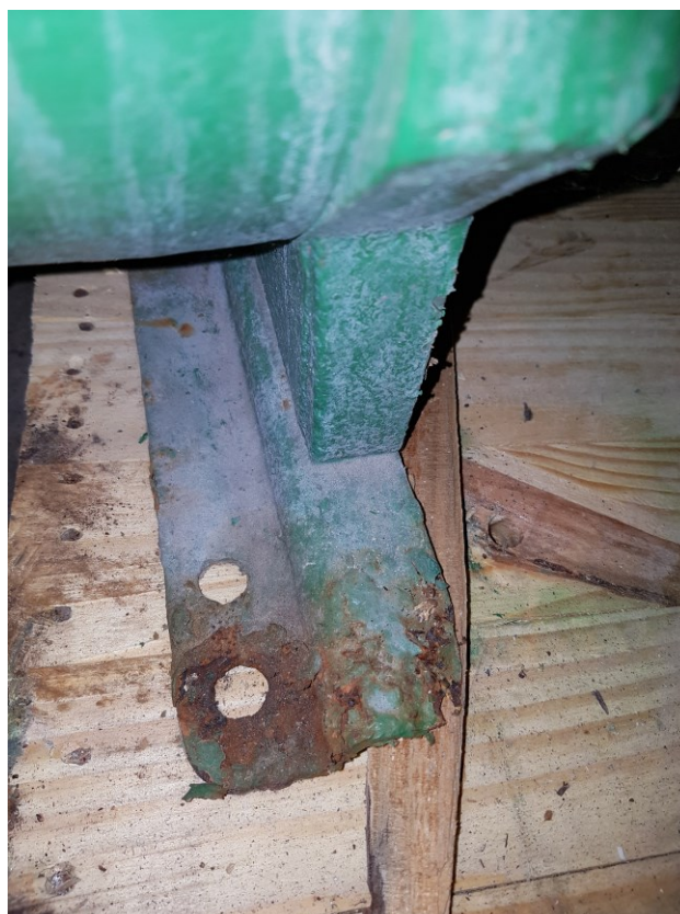
Figura 3 – Base oxidada/danificada do compressor COMP5A2.
