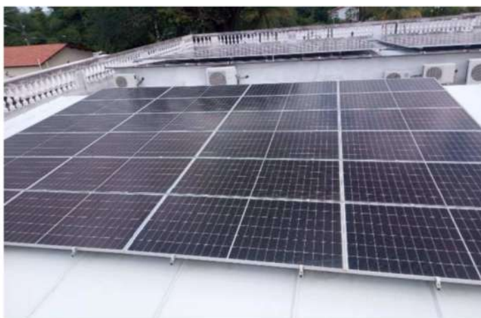
Foto 1. Usina Fotovoltaica de Iguatu
