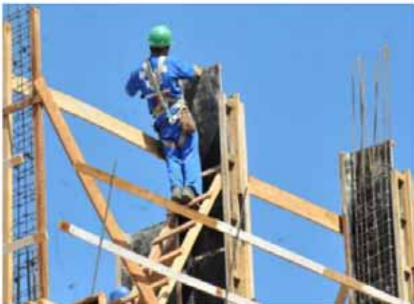
No Ceará, 58 trabalhadores morreram em consequência dos acidentes no ano passado. Foto: EBC
